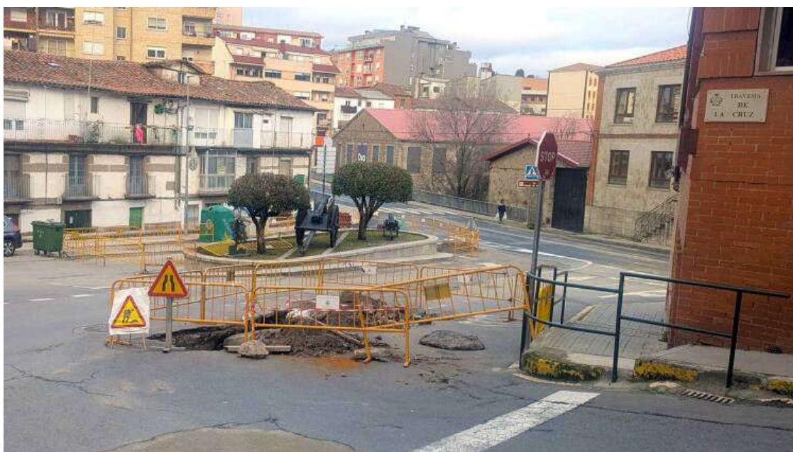
Avería en la red de abastecimiento de agua en la intersección de la Travesía de la Cruz en Béjar (Archivo)
