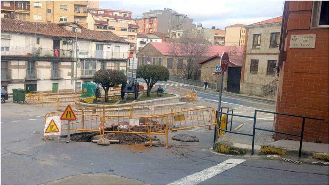
Avería en la red de abastecimiento de agua en la intersección de la Travesía de la Cruz en Béjar (Archivo)
